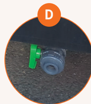
La vanne de vidange pour les eaux grises
